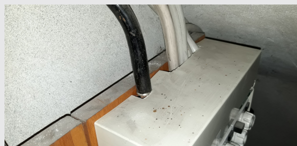
Sikringsskab med for store åbninger
