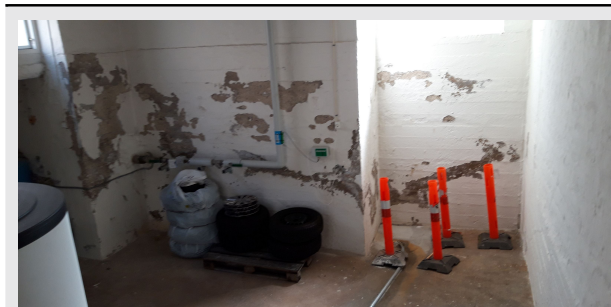
Afskalning af puds generelt i fyrkælder.
