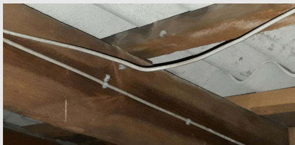
Kabel mangler mekanisk aflastning, generelt på lofterne
