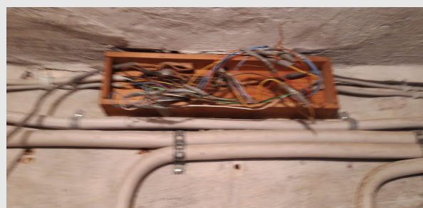
Samledåse mangler afdækning
