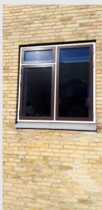
Nedbrudte fuger, med lokal reparation
