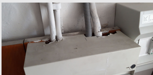
Sikringsskab med for store åbninger
