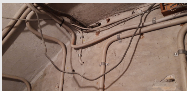
Kabler mangler mekanisk aflastning
